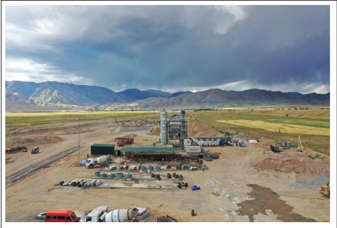
Рисунок 10 АБЗ на территории производственной площадки
