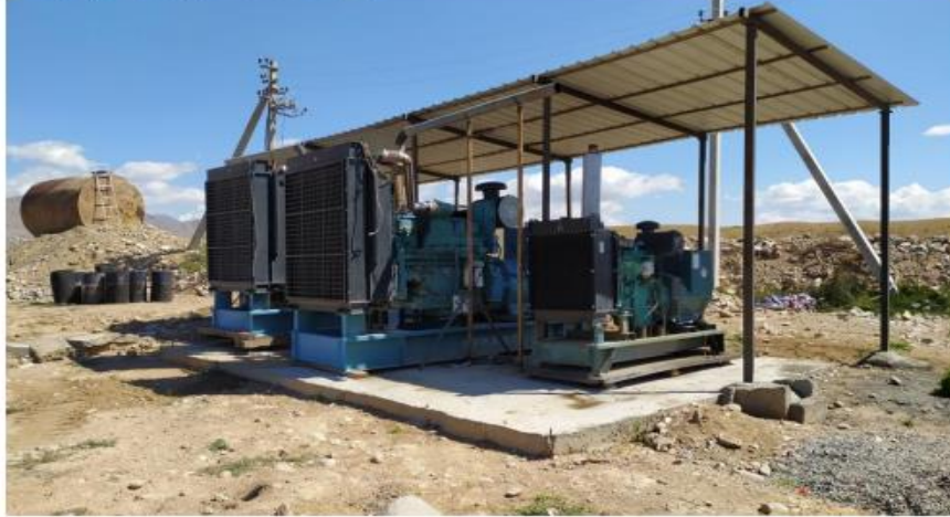
Фото 8. Генератор на производственной базе не огражден
