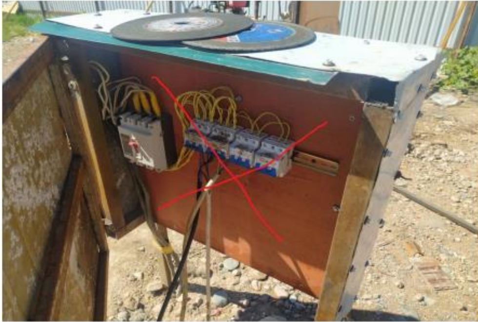
Фото 6: Электрический щит сделан из дерева, а не железный.
