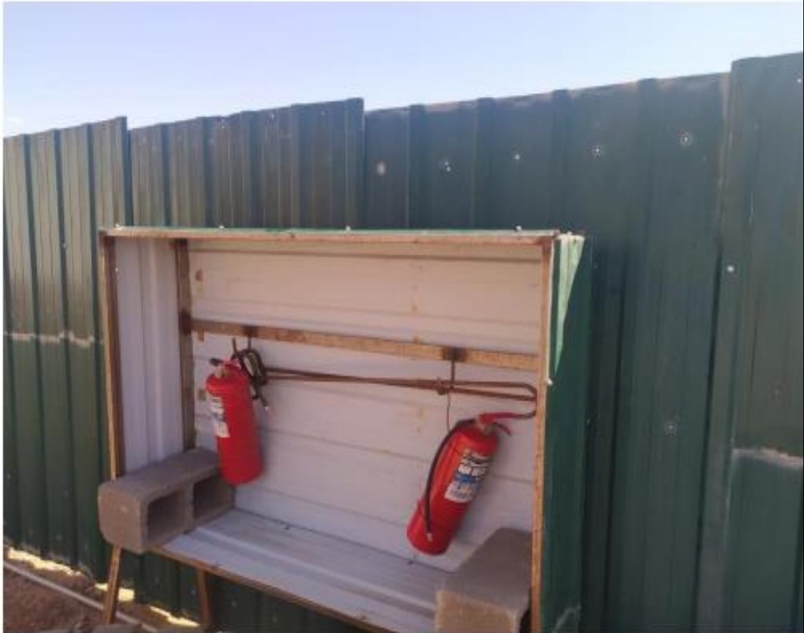
Фото 9: Противопожарные щиты не укомплектованы
