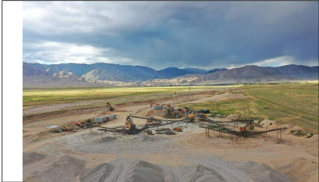
Рисунок 12 ДСУ на территории производственной площадки
