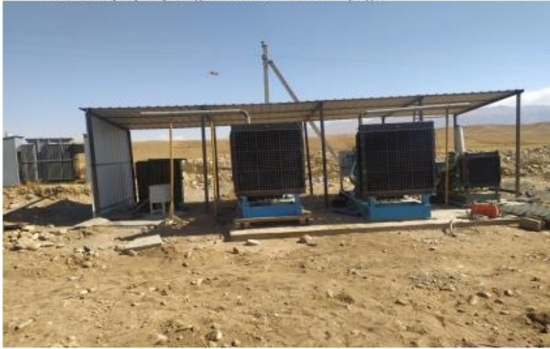
Photo 6. The generator is not completely fenced at the production base Фото 6. Генератор на производственной базе полностью не огражден
